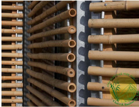
Ombrières (clairevoie) en bambou (photo : Chalet&Bambou)
